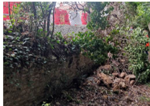
Vue intérieure de la propriété privée du mur de soutènement endommagé
